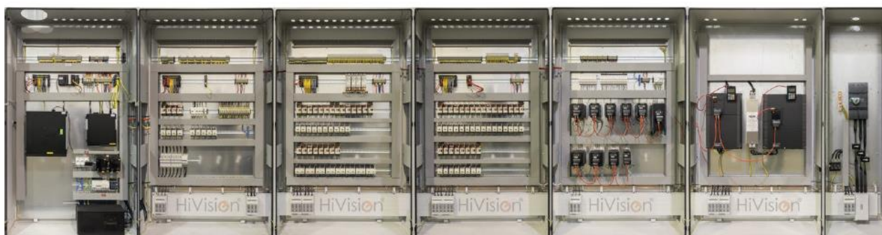
Obrázek 20 Ukázka rozvaděče linky
